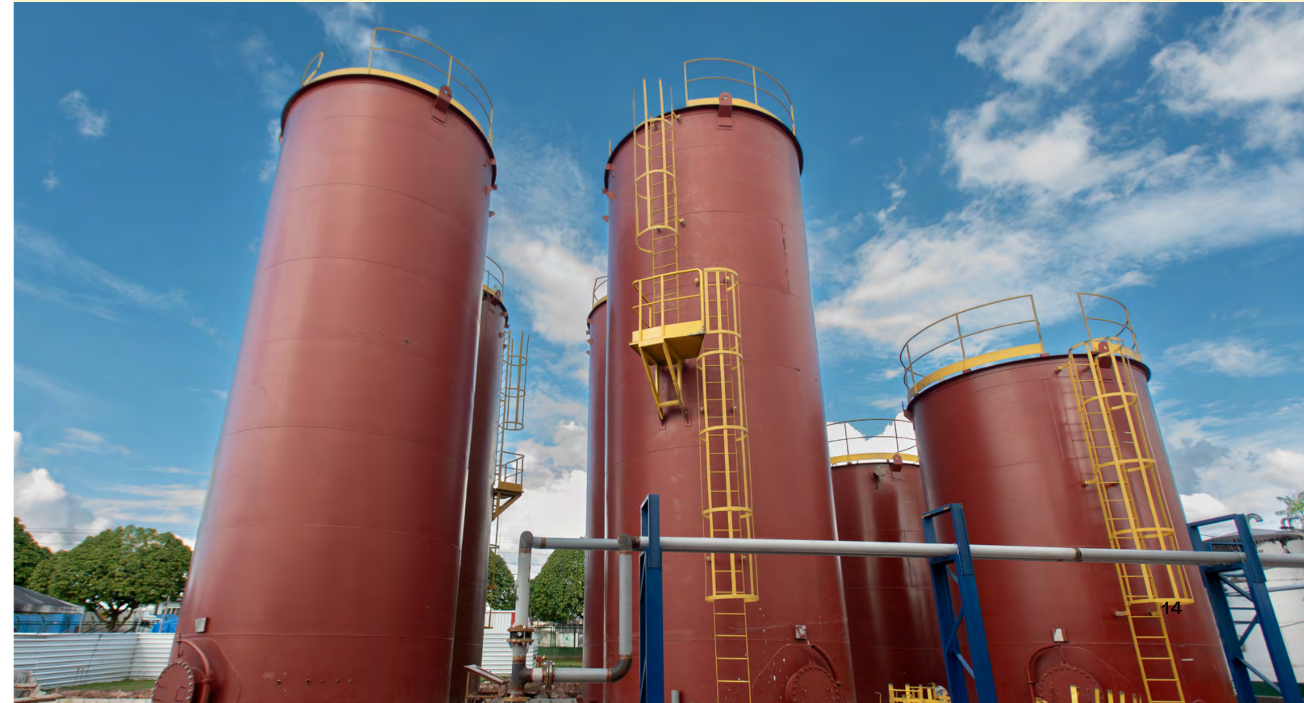
Biodiesel plant (Belém-PA)
